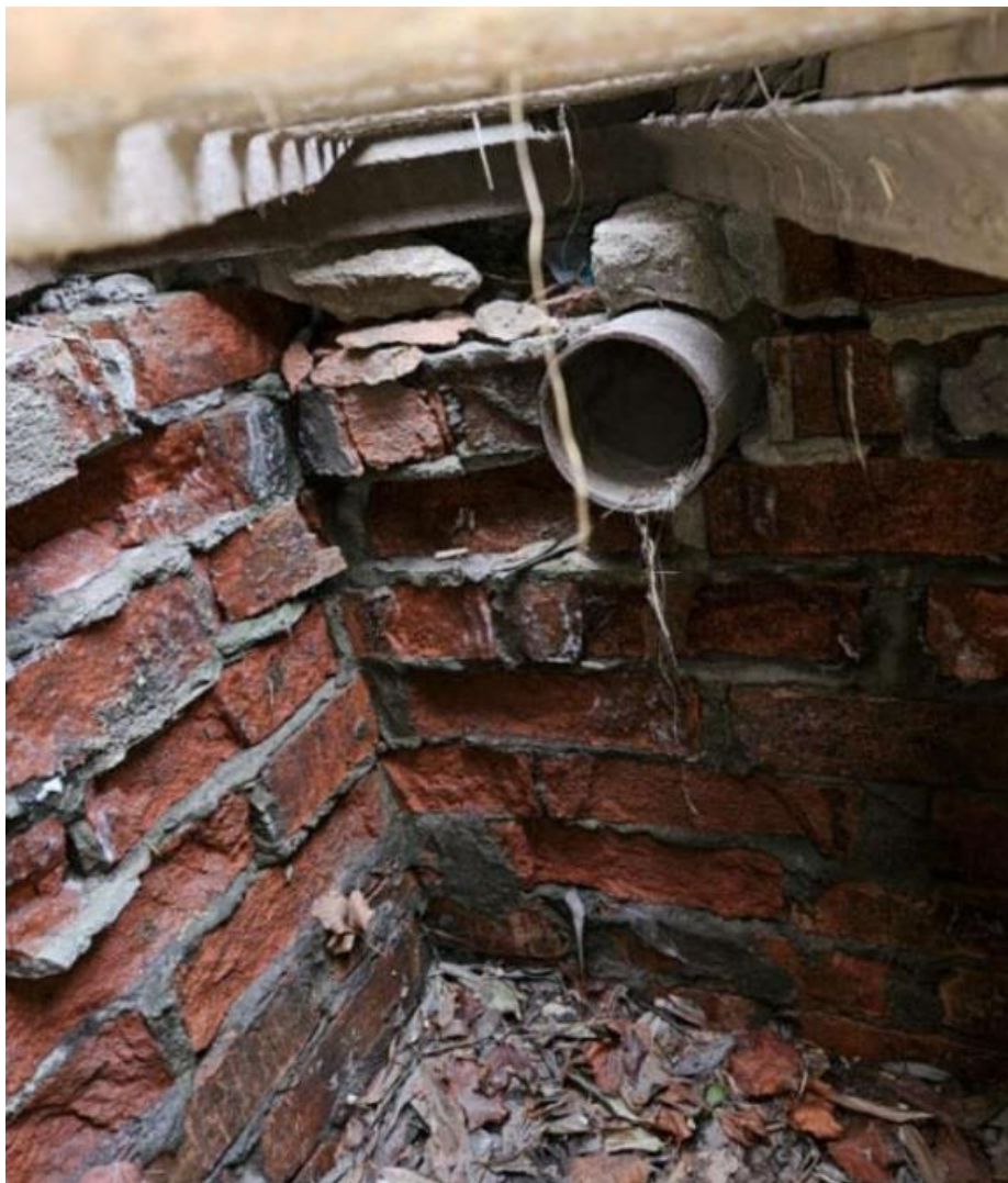
Фото Ф-28. Ливневая канализация под западным проездом. Разрушение кирпича дождеприемника.
