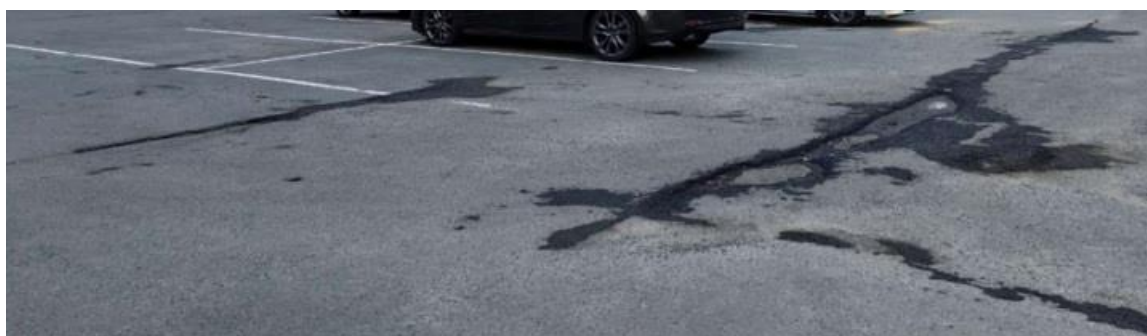
Фото Ф-22. II этап строительства. Открытая парковка в осях 1-7/А-Г. Выбоины в асфальте, способствующие скоплению сточных вод и дальнейшему их попаданию в кровельный пирог.
