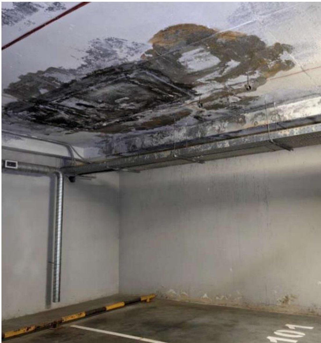
Фото Ф-4. II этап строительства. Следы систематических протечек по плите покрытия.
