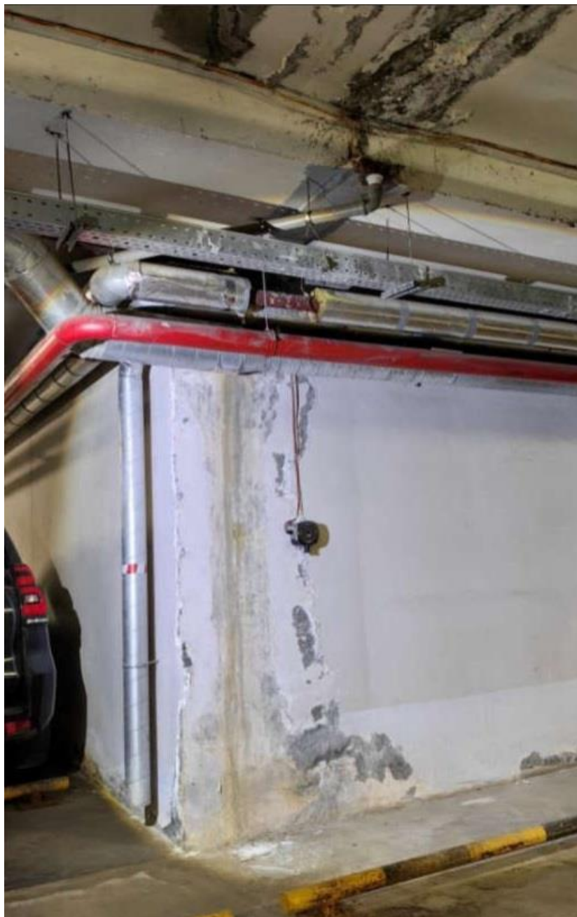
Фото Ф-12 . III этап строительства. Следы систематических протечек по плите покрытия и наружной стене. Трещины в плите покрытия.
