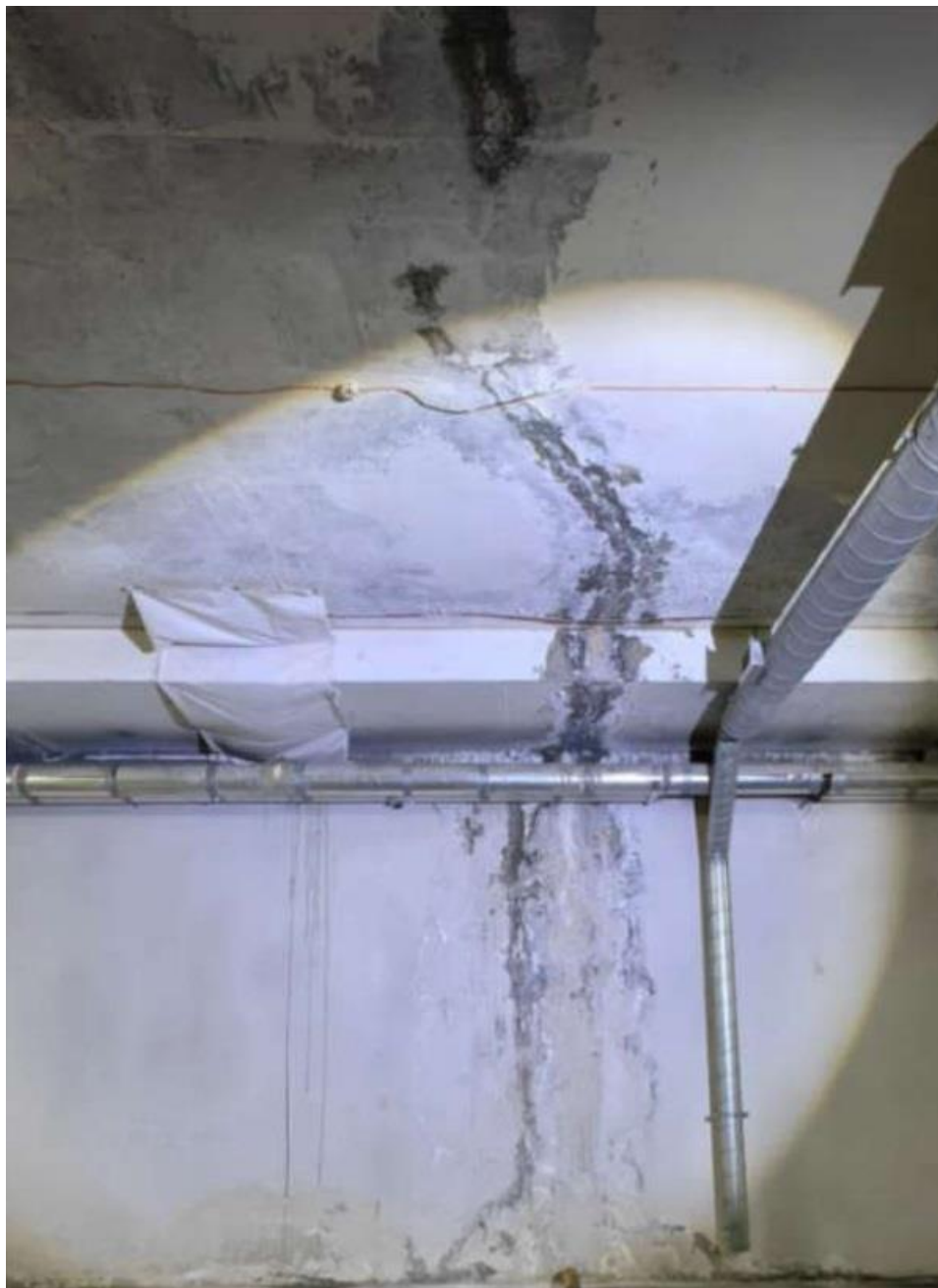
Фото Ф-1. II этап строительства, оси 6-7/Ж. Следы систематических протечек по плите покрытия. Трещины в плите покрытия.
