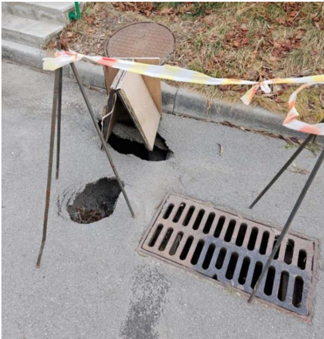
Фото Ф-26. Ливневая канализация под западным проездом. Просадки и разрушения асфальтобетонного покрытия, разрушение дождеприемника.
