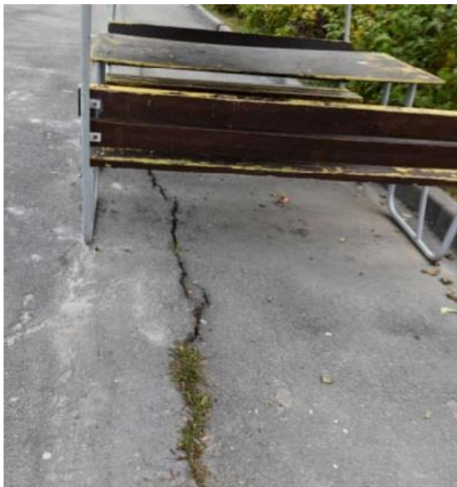
Фото Ф-23. Трещины в асфальте вдоль наружной стены парковки, через которые происходит попадание сточных вод в кровельный пирог. Произрастание растительности в трещине. Наличие бордюра вдоль западной границы асфальтированной части парковки, препятствующем стоку вод.
