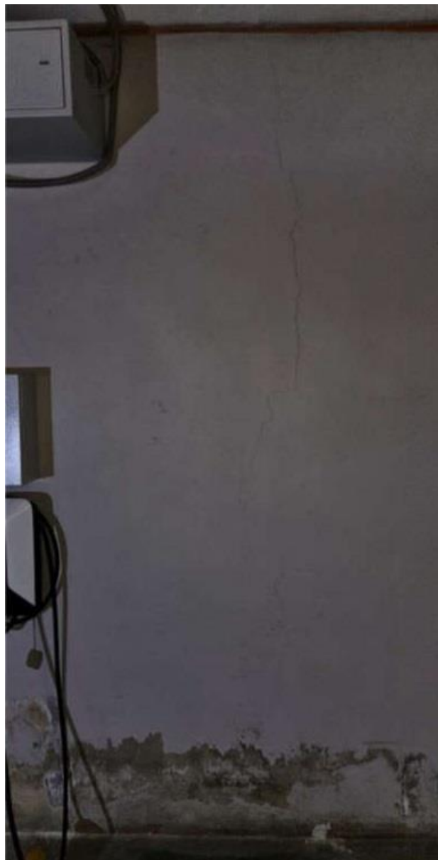
Фото Ф-15. III этап строительства. Вертикальная трещина по внутренней продольной стене по оси «Б»
