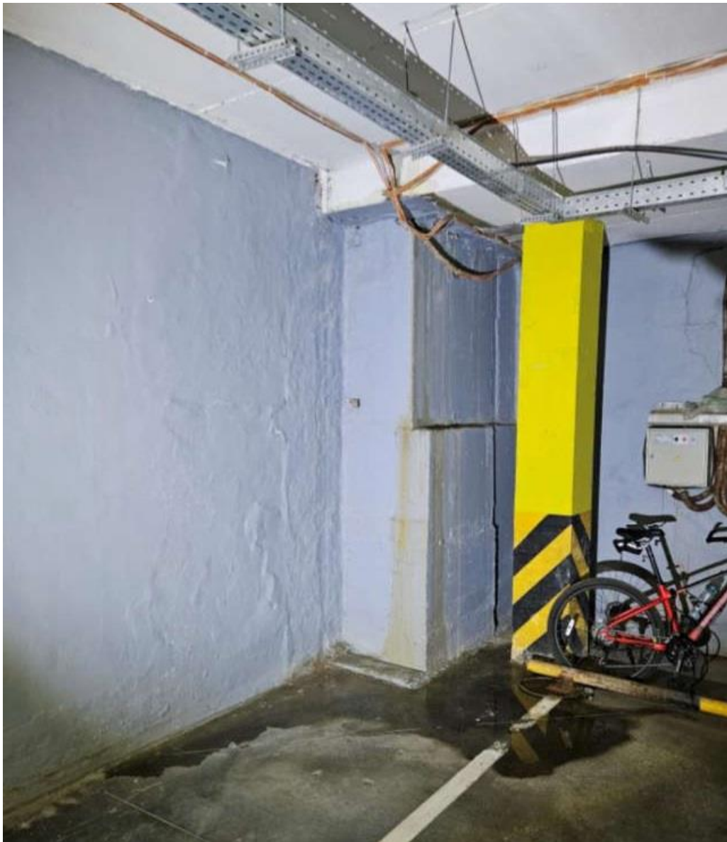
Фото Ф-9. III этап строительства, оси А-Б/4-7. Активные протечки по деформационному шву и наружной стене.
