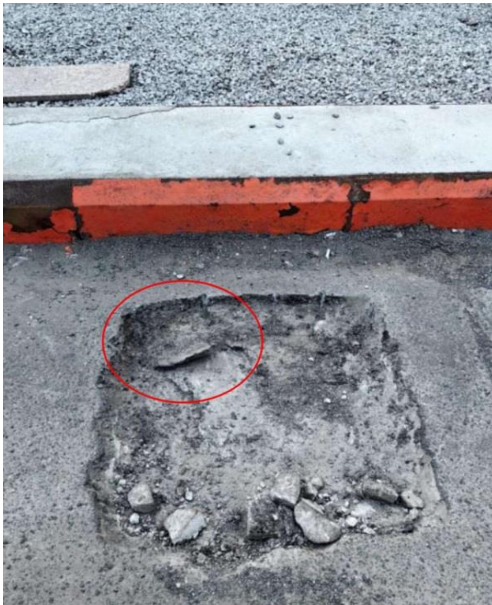
Фото Ф-21. II этап строительства. Участок в осях 1-2/Е-Ж, проезд на парковку через шлагбаум. Вырубка в асфальте с повреждением гидроизоляции.
