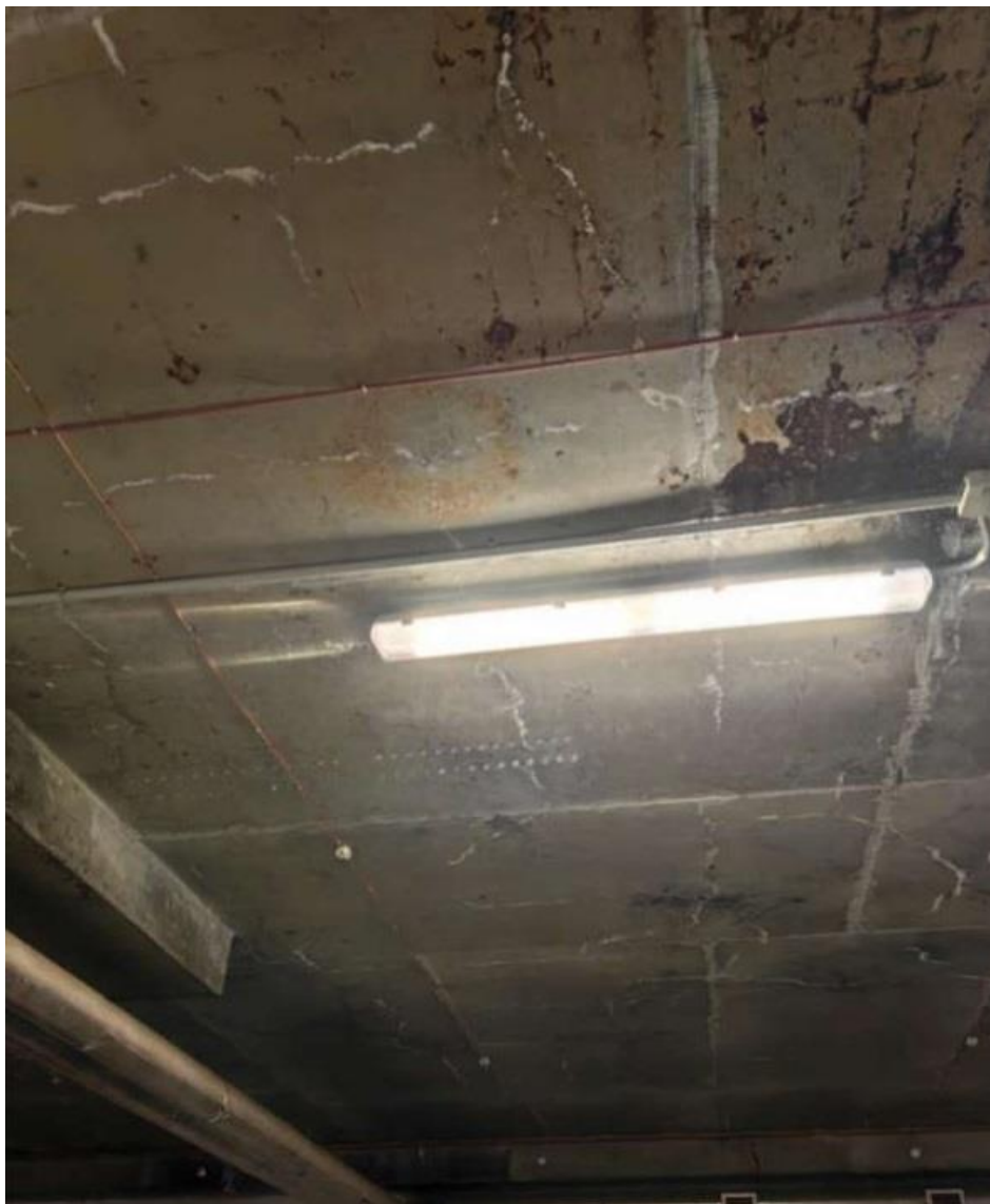
Фото Ф-17. III этап строительства. Сетка трещин по плите покрытия на участках, поверженных воздействию высоких температур при пожаре, произошедшем на стадии строительства.
