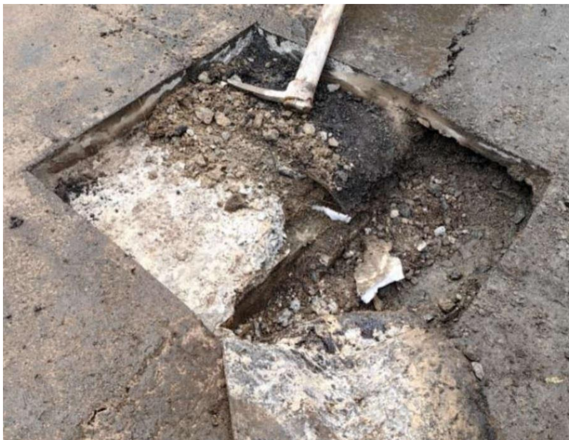
Разрыв гидроизоляции по вертикальной поверхности Шурф Ш-1
