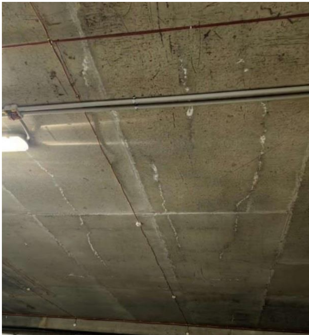
Фото Ф-16. III этап строительства. Трещины по плите покрытия.
