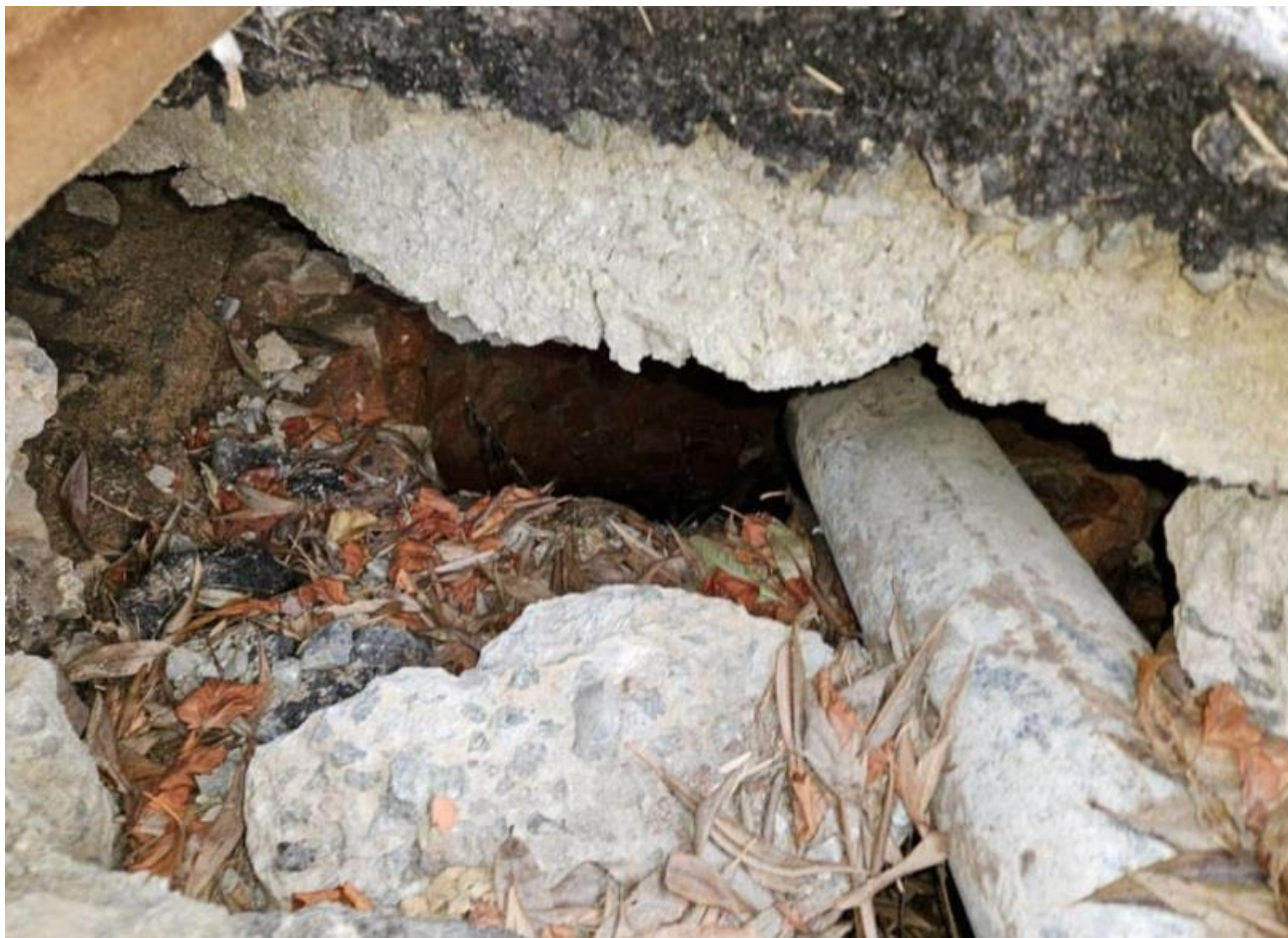
Фото Ф-27. Ливневая канализация под западным проездом. Просадки и разрушения асфальтобетонного покрытия, разрушение дождеприемника.
