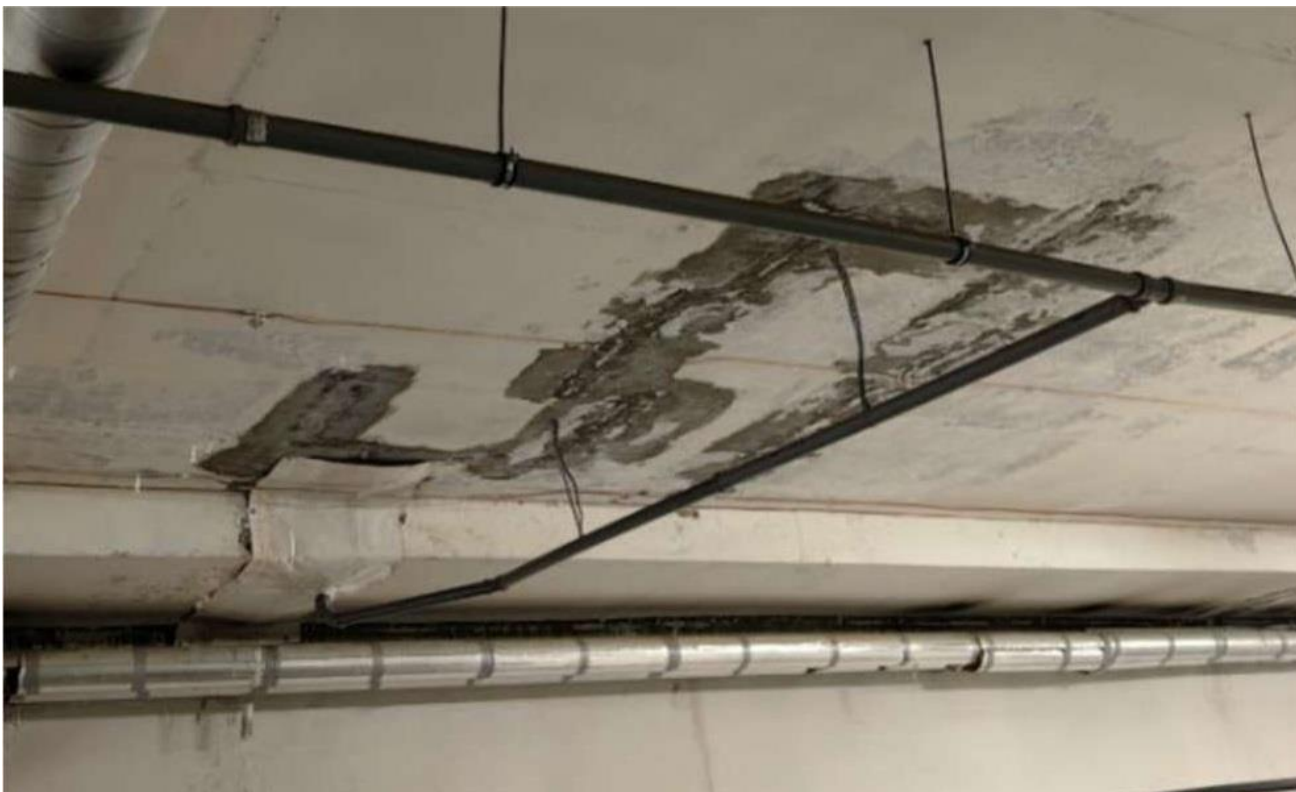
Фото Ф-6. II этап строительства. Следы систематических протечек по плите покрытия. Трещины в плите покрытия.
