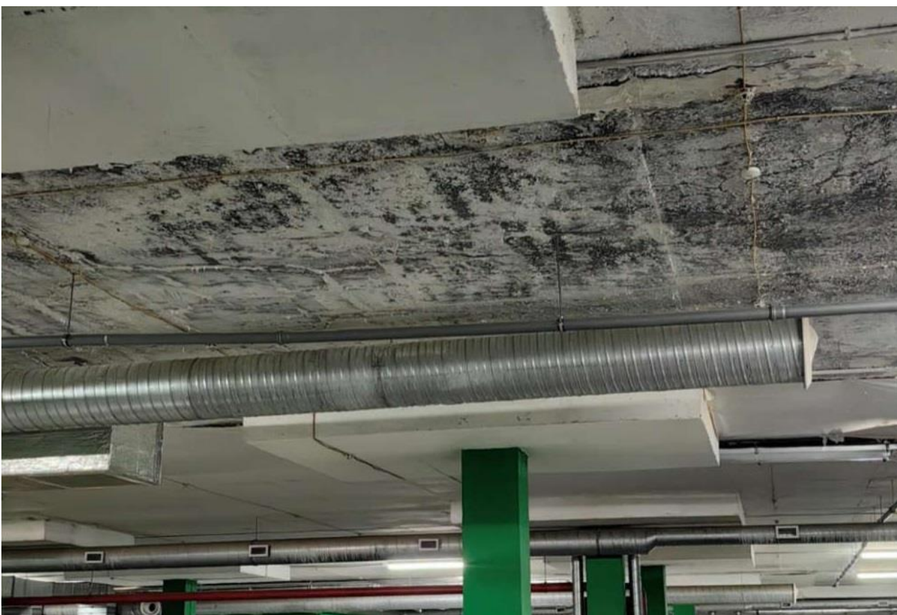
Фото Ф-7. II этап строительства. Следы систематических протечек по плите покрытия.
