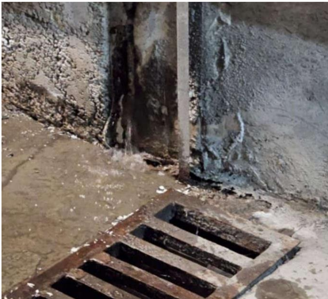
Фото Ф-20.1 Деформационный шов в стене в осях 36/Б. Активная течь сквозь деформационный шов.
