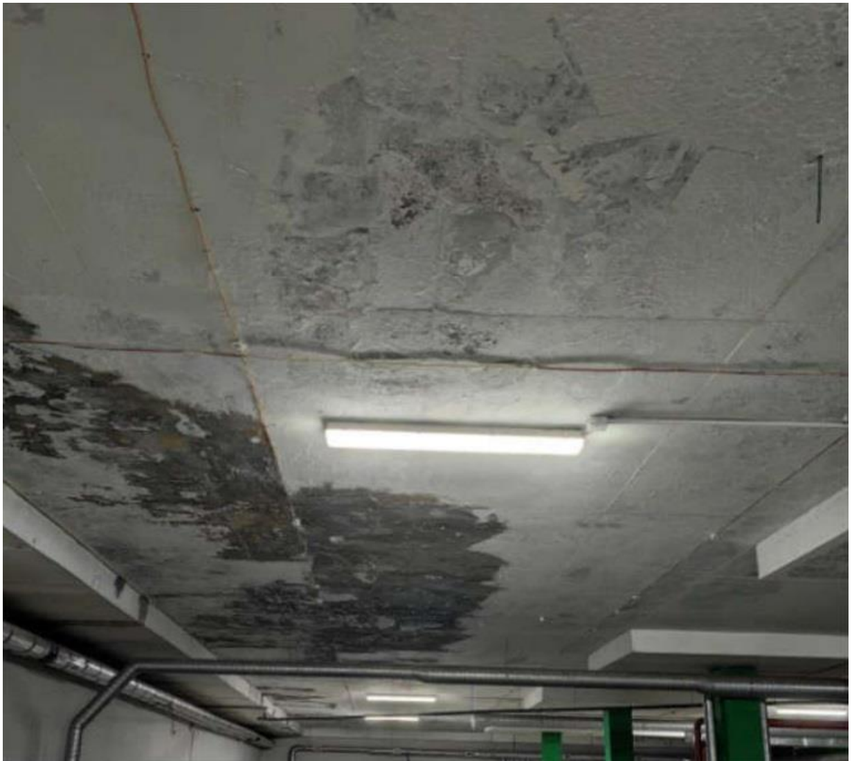
Фото Ф-3. II этап строительства. Следы систематических протечек по плите покрытия.
