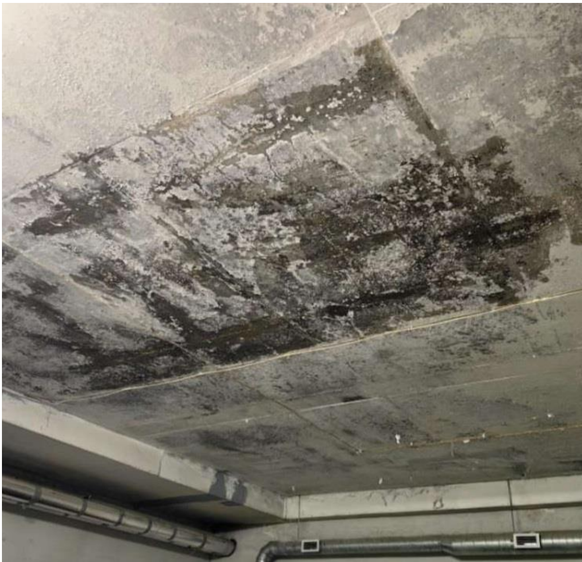
Фото Ф-5. II этап строительства. Следы систематических протечек по плите покрытия.
