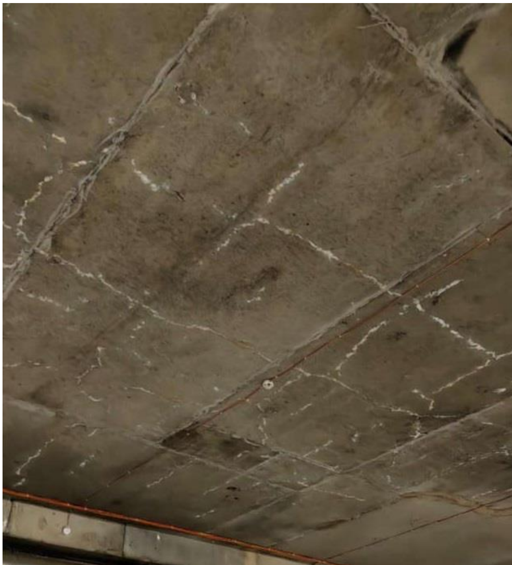
Фото Ф-18. III этап строительства. Сетка трещин по плите покрытия на участках, подверженных воздействию высоких температур при пожаре, произошедшем на стадии строительства.
