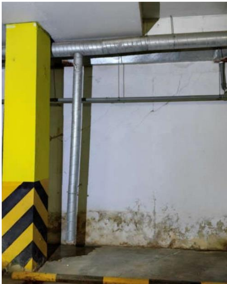
Фото Ф-11. III этап строительства. Наклонные трещины по стене расположенной в деформационном шве. Следы намокания по низу стены.
