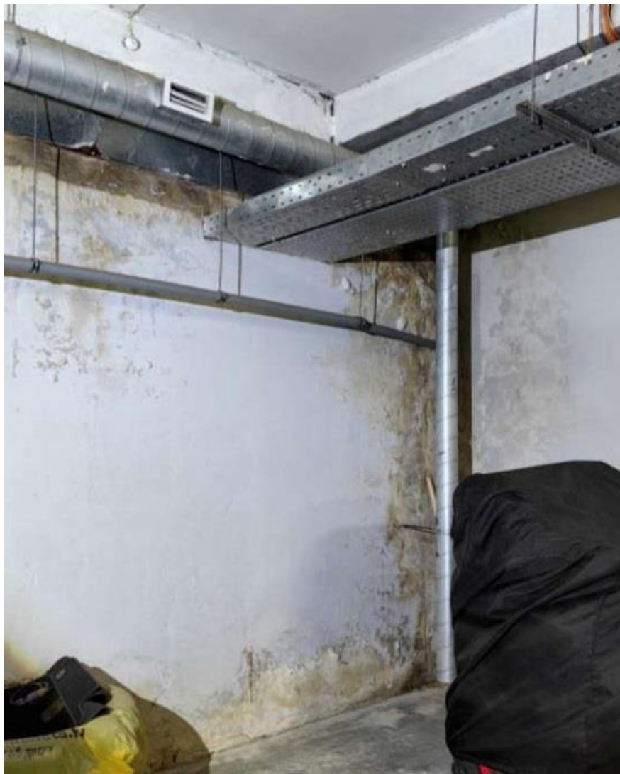
Фото Ф-10. III этап строительства, оси А-Б/4-7. Следы протечек по деформационному шву и наружной и внутренним стенам.
