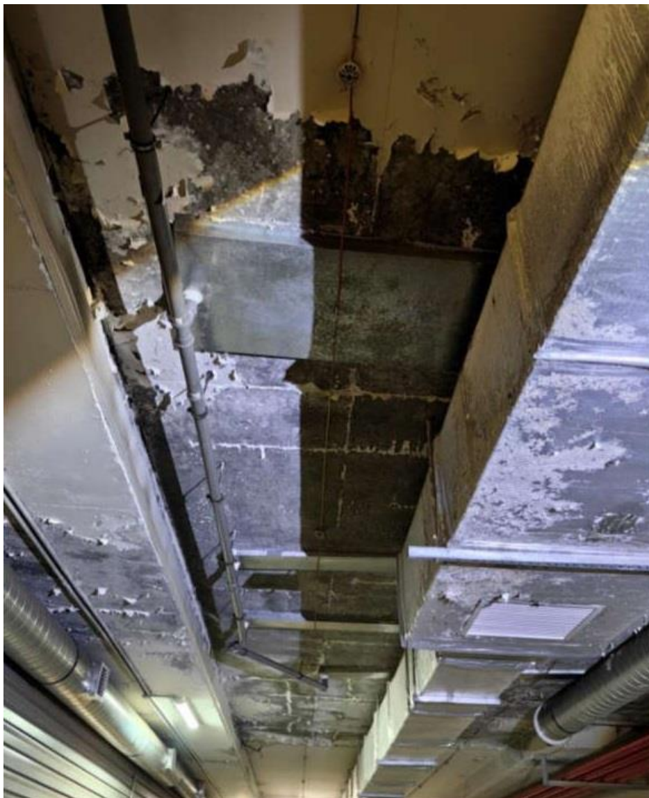
Фото Ф-8. II этап строительства, оси 4-7/А-Б. Следы систематических протечек по плите покрытия.
