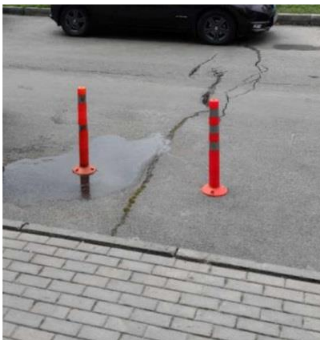
Фото Ф-24. Деформационный шов между II и III этапами строительства. Трещины в асфальте по деформационному шву, через которые происходит попадание сточных точных вод (в том числе с кровли жилого дома) в кровельный пирог.
